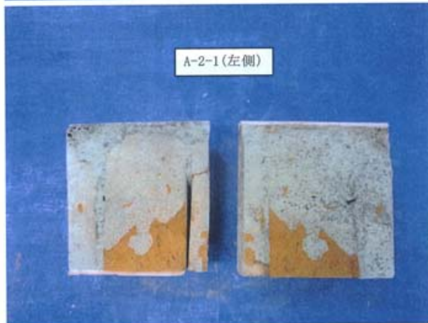
写真-64 目地モルタルの破壊状況 (写真-63 左側) [A-2-1]
