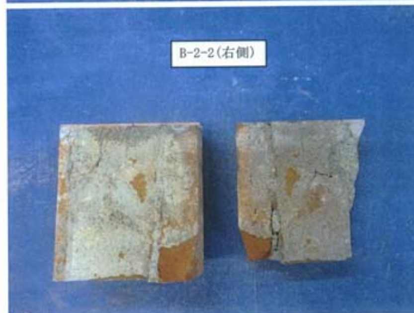
写真-92 目地モルタルの破壊状況 (写真-90 右側) [B-2-2]
