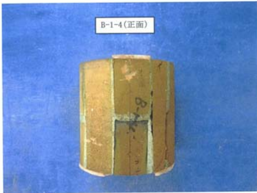
写真-81 目地モルタルの破壊状況 (正面) [B-1-4]
