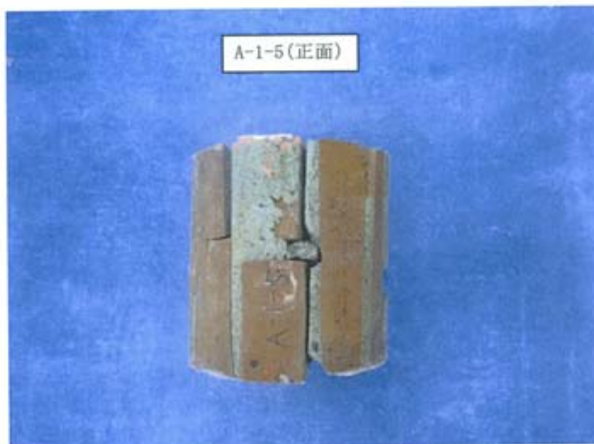
写真-60 目地モルタルの破壊状況 (正面) [A-1-5]
