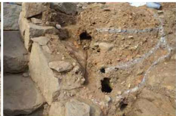
土砂流出による空隙
