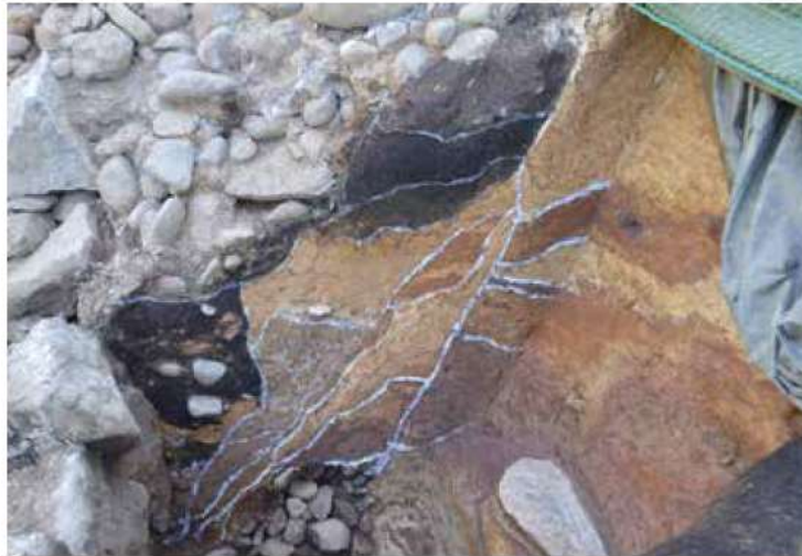
写真2 S1セクションの滑り面
