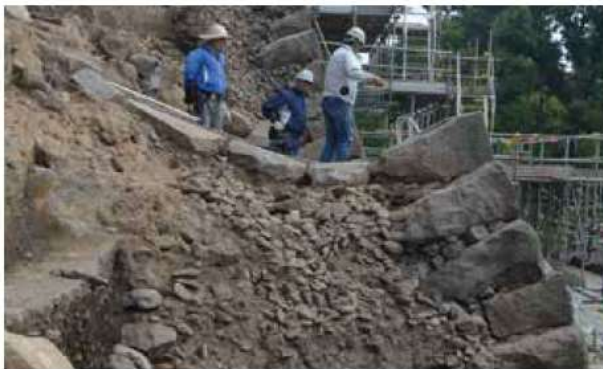
石垣の孕み出しによる変形(南から)
