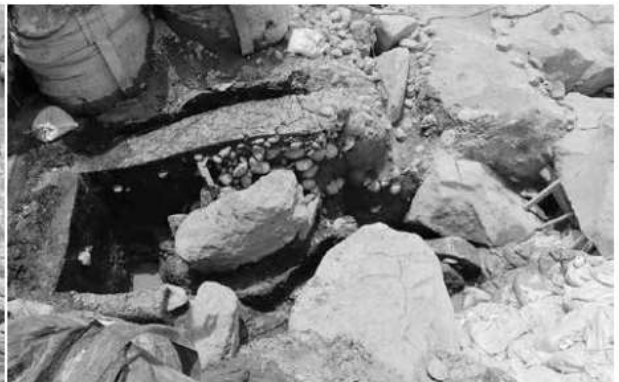
Gトレンチ内濠石垣（慶長期）上段部崩落状況（北から）
