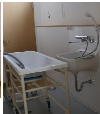
↑ 障害児用入浴槽
