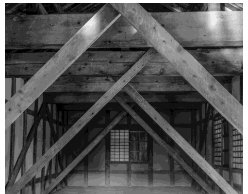
修理前の筋違い〔二の丸南門2階〕
