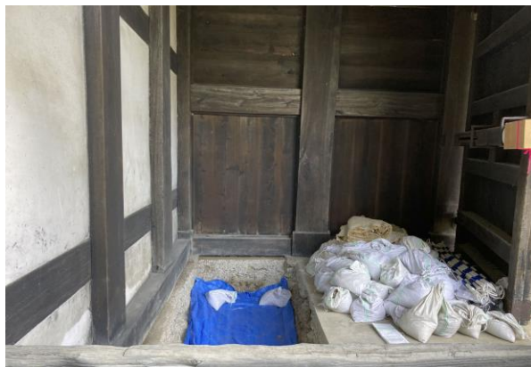
耐震補強前〔三の丸追手門東内壁〕
