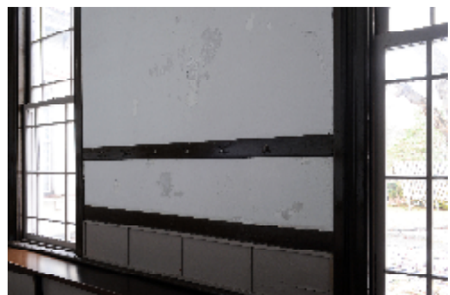
写真 27 北面廊下北面壁の破損状況
