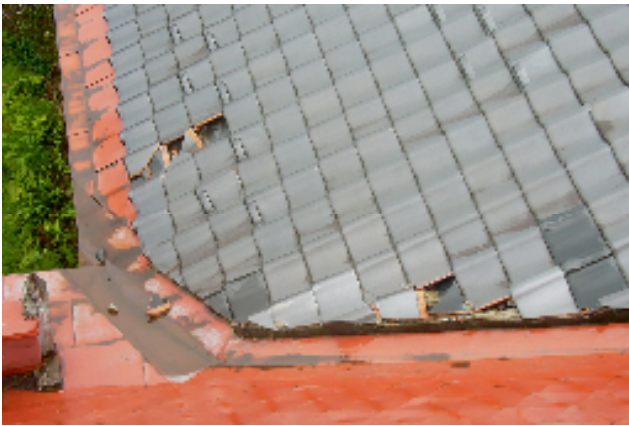
写真 19 屋根の破損状況
