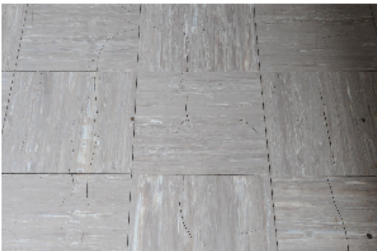
写真 30 床タイルの破損状況 北面廊下
