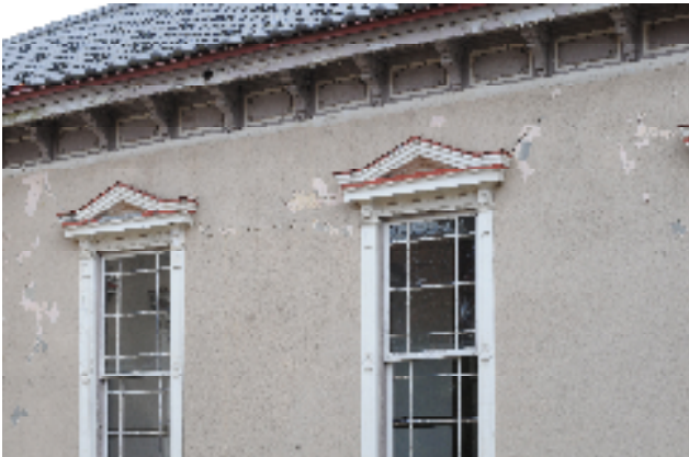
写真 15 外壁の破損状況 北面玄関東寄り
