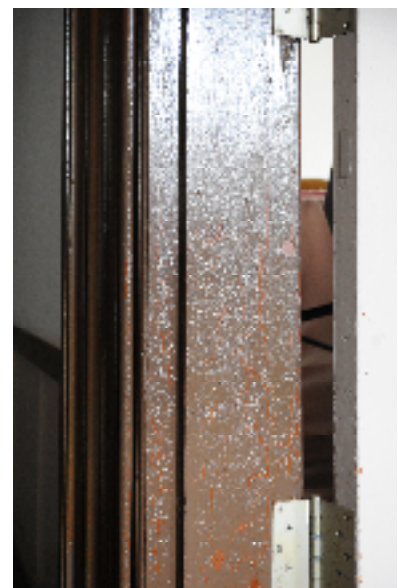
写真 31 オイルペイントの状況
