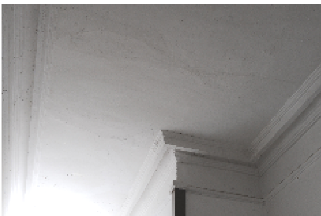
写真 26 北面廊下（「廊下1」）天井廻り漆喰塗の 破損状況
