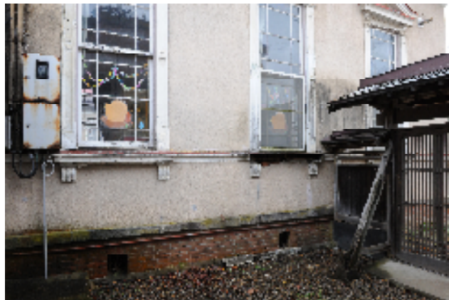
写真 14 基礎廻りの破損状況東面 (塀及び門平成 24 年度解体済)
