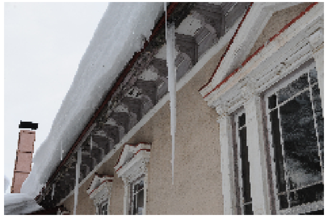
写真 20 軒裏 水が内部に回っている状況
