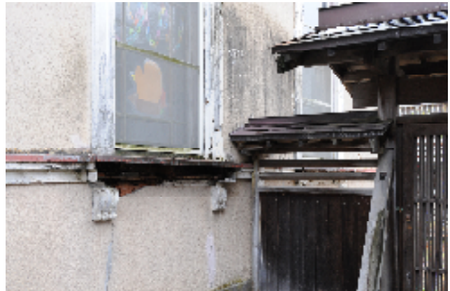
写真 16 東面窓廻りの破損状況 「球突場」部分 (塀及び門平成 24 年度解体済)
