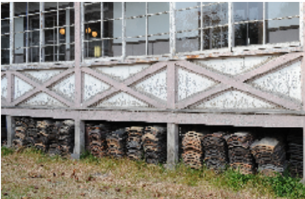
写真 21 南面廊下外壁塗装の破損と旧屋根瓦保存状況
