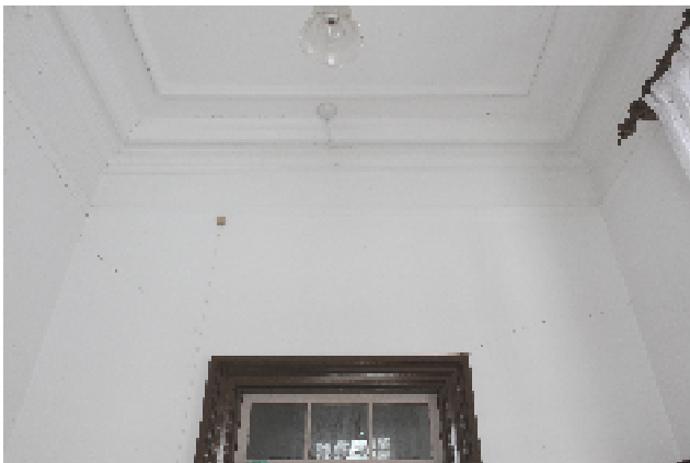
写真 24 「応接所」南面壁のクラック
