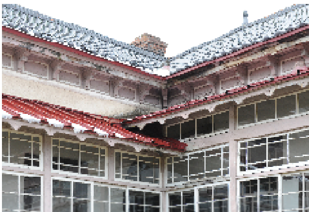
写真 17 軒廻りの破損状況 南面南西入隅部
