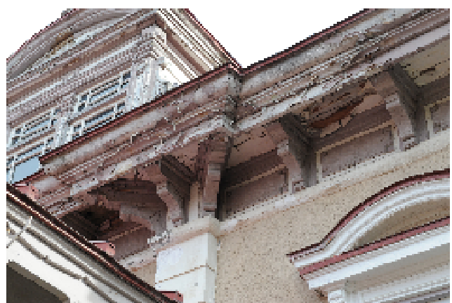
写真 18 軒廻りの破損状況 北面正面部分
