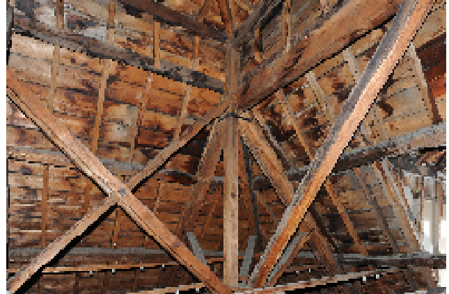
写真 29 玄関小屋裏の雨漏り状況 北西を見る
