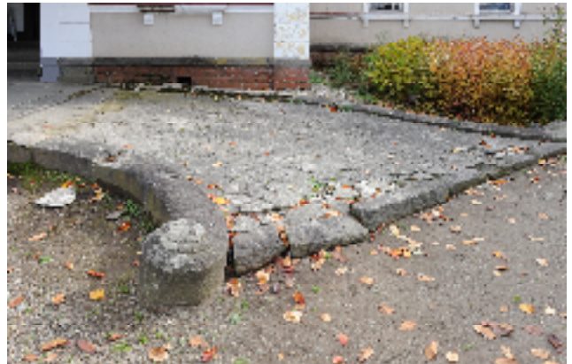
写真 22 玄関車寄せ路面の破損状況
