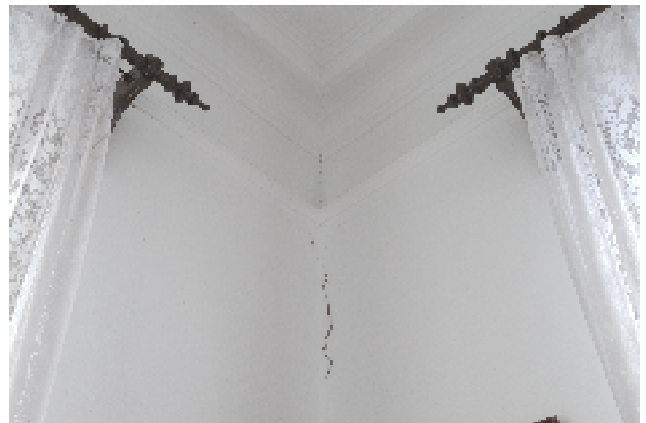
写真 25 「応接所」北西隅壁のクラック
