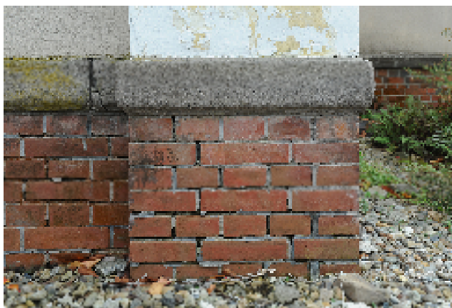
写真 11 煉瓦積基礎目地の破損状況 玄関廻り
