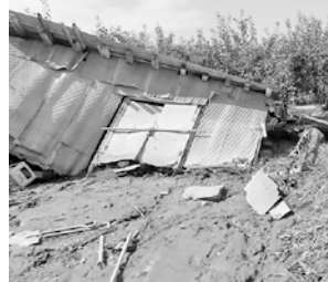
水害により倒壊した小屋
