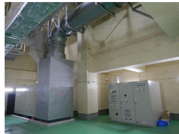
【 非常用発電機 】
