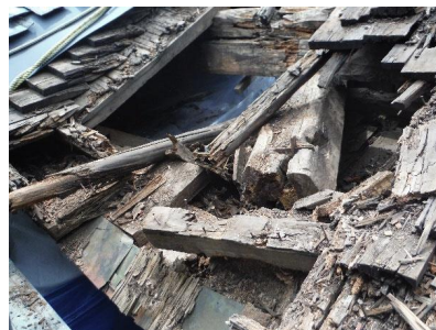
<拝殿屋根腐朽状況>
